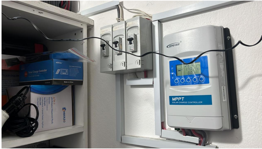
Figura 10 Instalación de controlador
