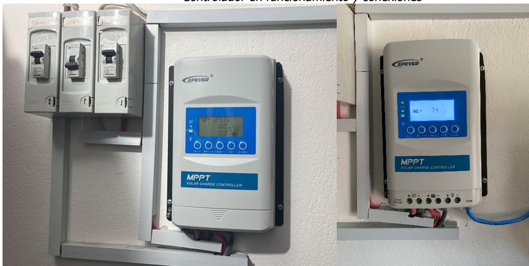
Figura 19 Controlador en funcionamiento y conexiones
