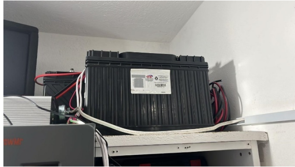
Figura 11 Instalación de baterías
