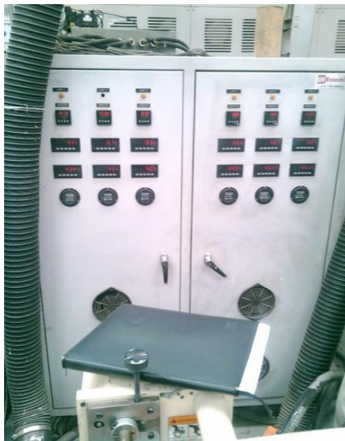
Figura 22. Segundo controlador de lámparas UV en proceso. Elaboración propia.
