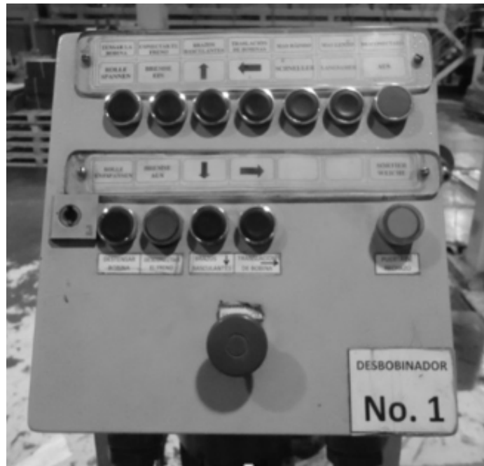
Figura 4.4 Estación de mandos local desbobinador.
