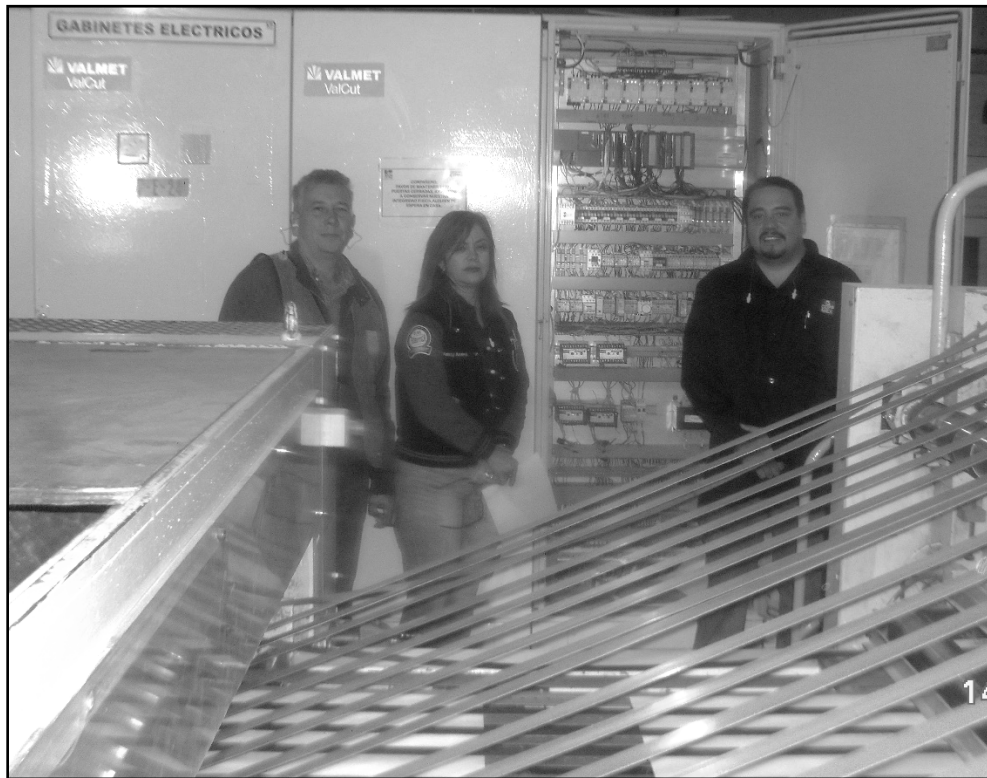
Figura 4.38 Vista de gabinete eléctrico y PLC S7-300.
