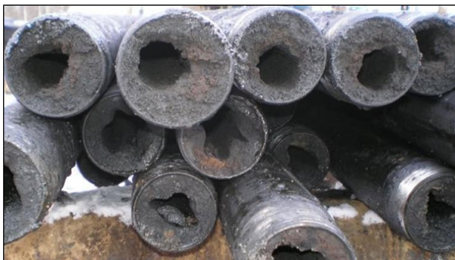
Figura 0.2 Asfaleno depositado en las paredes de las tuberías. Fuente (Lijó, 2010)
