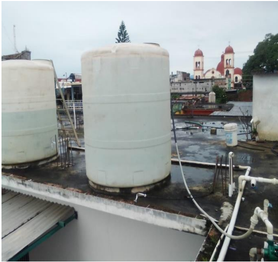
Ilustración 13. Tanque de almacenamiento.
