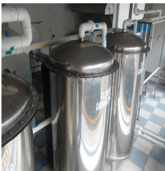
Ilustración 19. Filtros (arena, carbón y suavizador)
