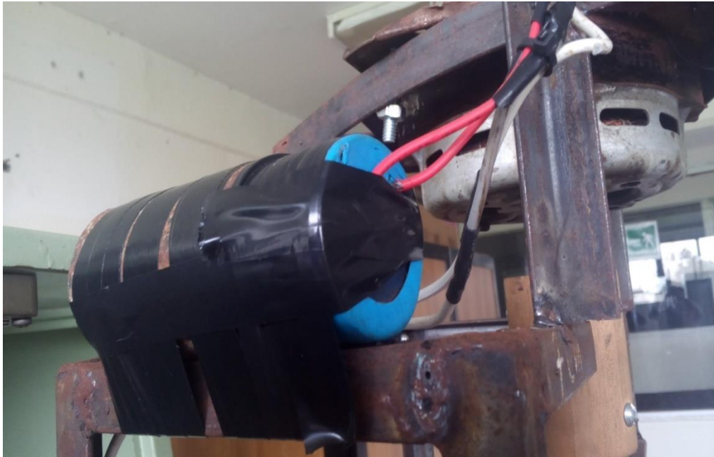
Figura 7. Capacitor y motor colocados en la parte superior.
