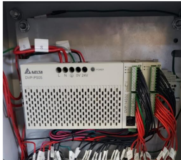
Figura 31. PLC Marca Delta DVP-14SS2.
