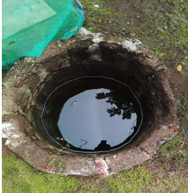
Anexo 4. Pozo con borde de protección de altura baja.
