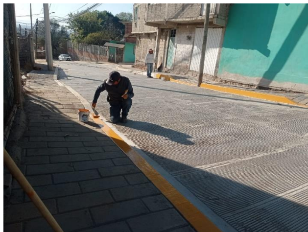
Fotografía 18 – Pintura en guarniciones
