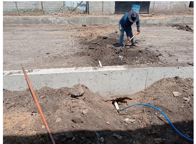
Fotografía 12 – Conexión de toma larga
