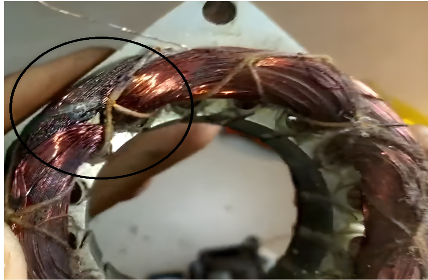
Figura 10. Devanado con aislamiento degradado.
