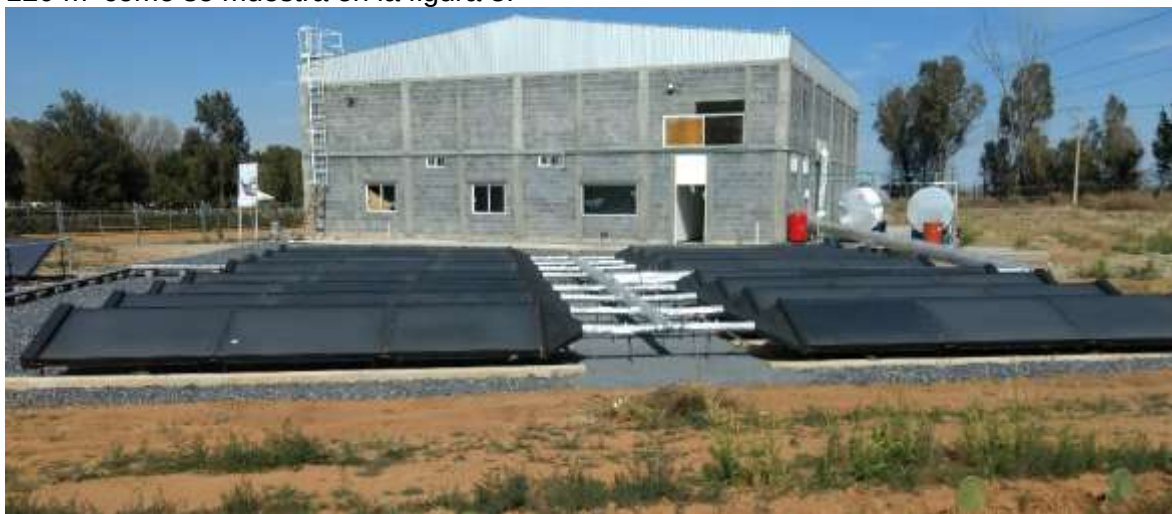
Figura (3) 48 Calentadores solares de aire instalados.
