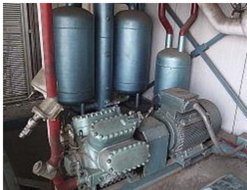
Compresor industrial de 64 kW (86 HP ) para R22 .
