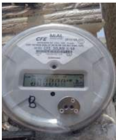
Figura 2.10 Medidor bidireccional instalado en la vivienda unifamiliar
