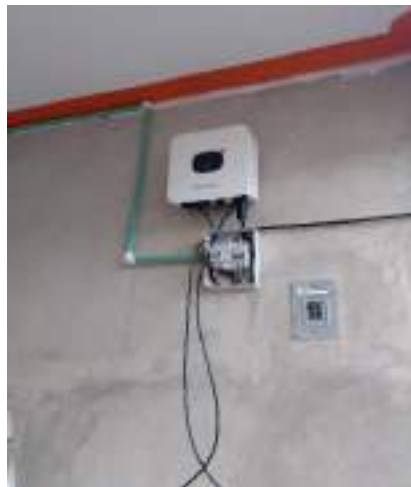
Figura 4.13 Ubicación del inversor en la vivienda unifamiliar
