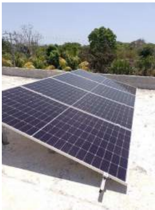
Figura 4.12 Paneles solares instalados en la vivienda unifamiliar de Dzitbalché
