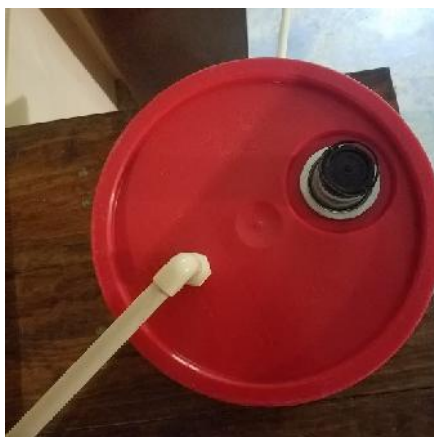
Fig. 0.18 Entrada de la bomba de agua
