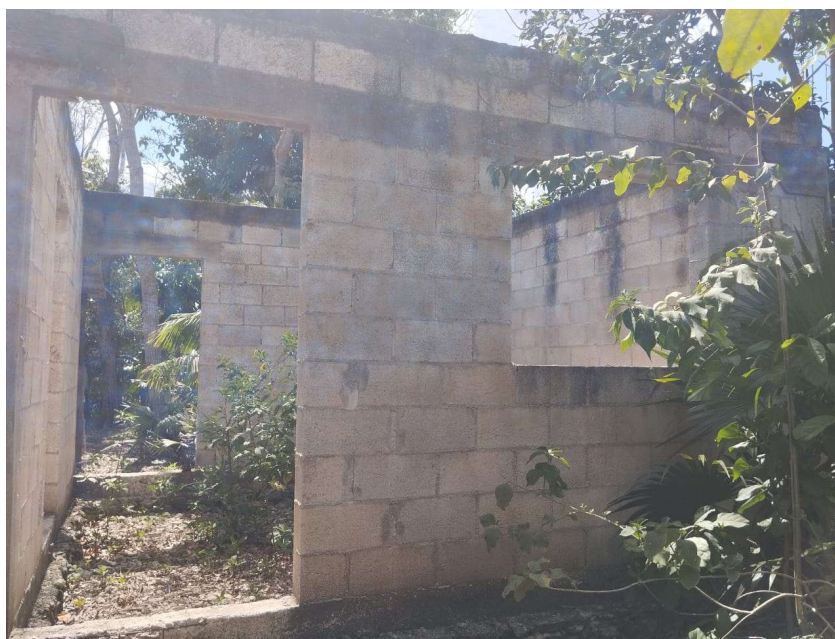
Figura 4. 4. Vivienda inconclusa, los materiales fueron suministrados por un programa de vivienda
