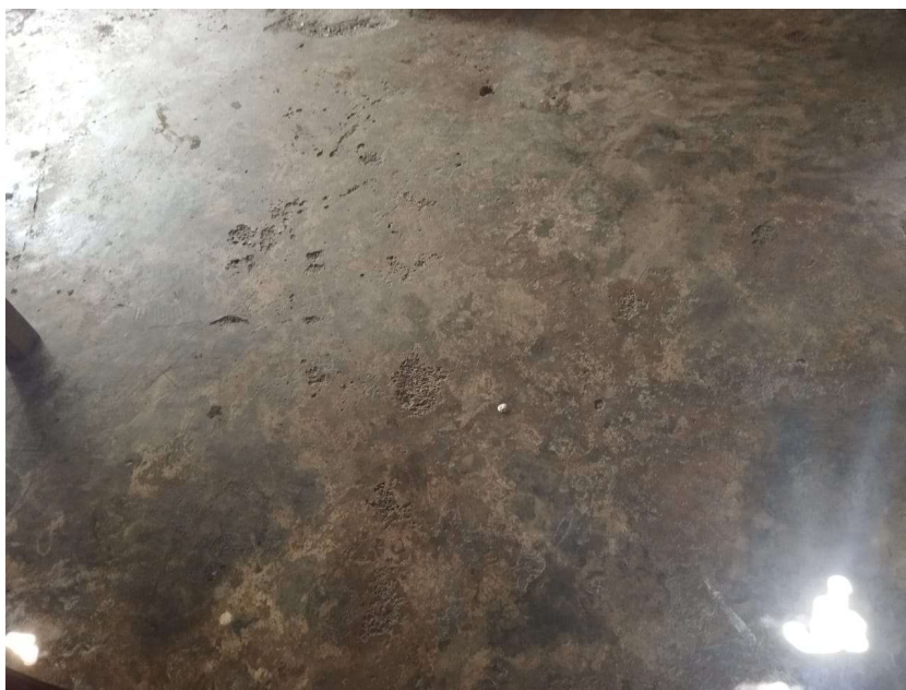
Figura 4. 2. Desgaste en piso entregado a través del Programa "Piso Firme"
