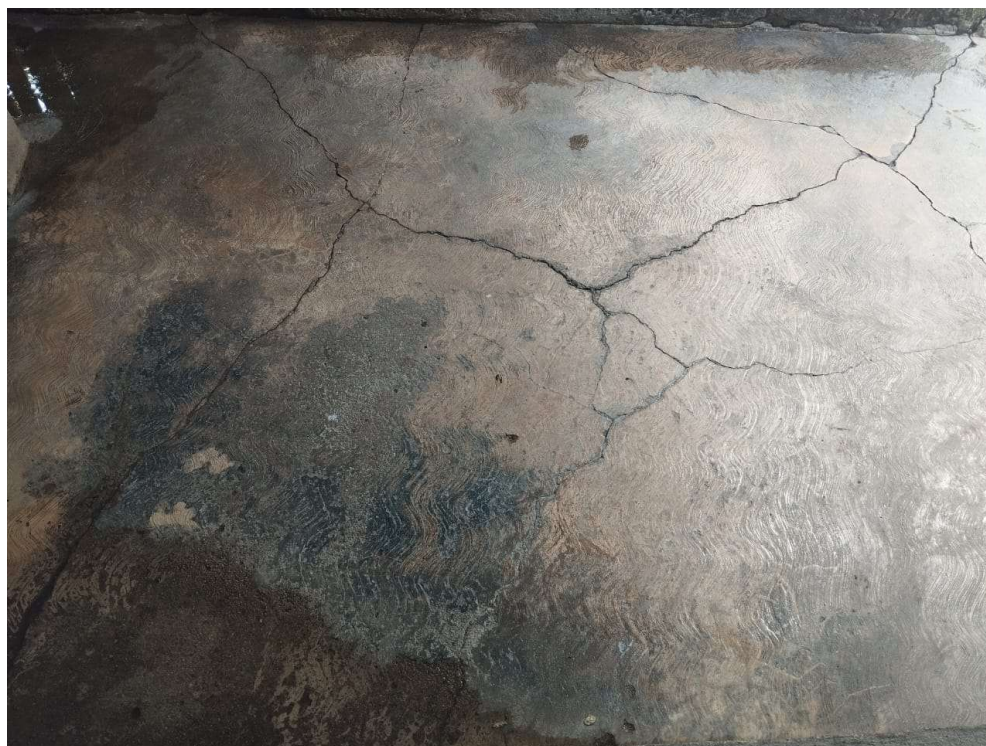
Figura 4. 1. Grietas en piso entregado a través del Programa "Piso Firme"
