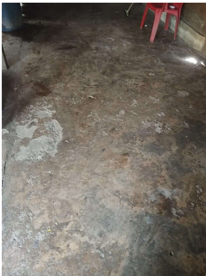
Figura 4. 3. Desprendimiento de acabado en piso entregado a través del Programa "Piso Firme"
