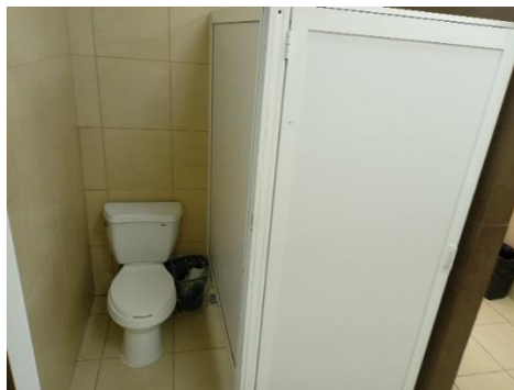
Sanitarios sin barras de apoyo en edificio G
