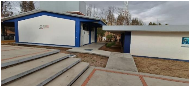
Rampa del edificio P, no contiene barandal
