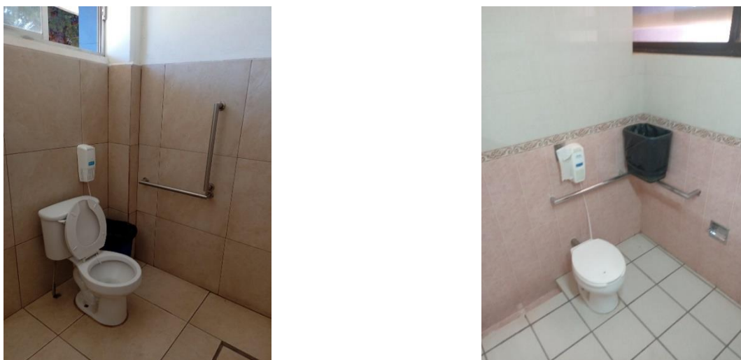
Barras de apoyo en sanitarios del edificio R y W
