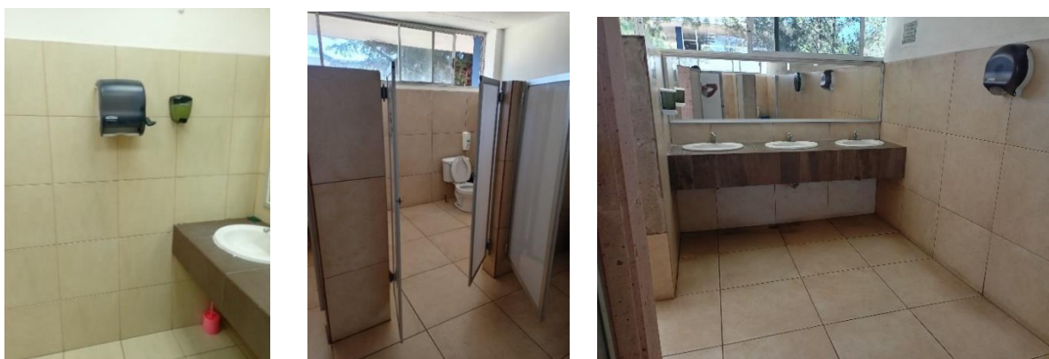
Accesorios en sanitario del edificio G y R
