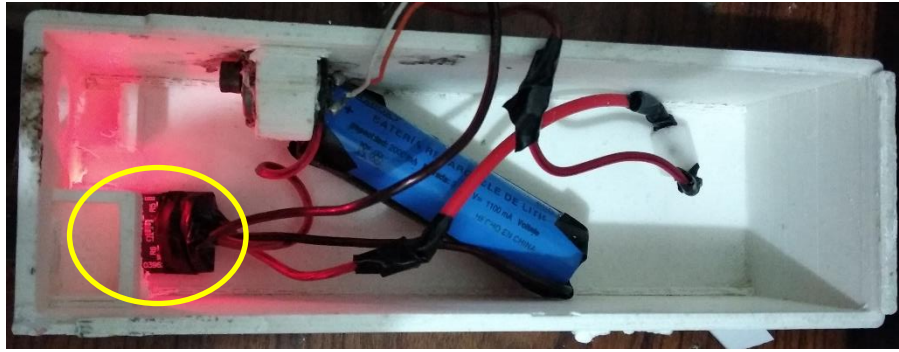
Figura 131.- Power bank instalada y cargando.
