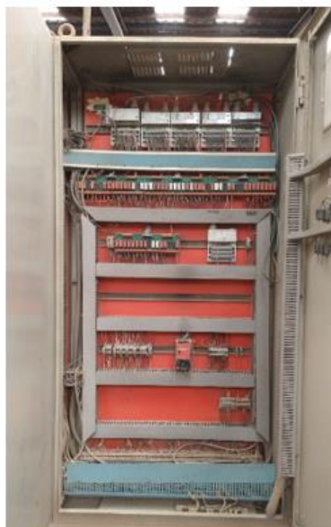
Figura 60-4.2-1 Tablero de las tarjetas de PLC y expansión Momentum de apilado planta 1.
