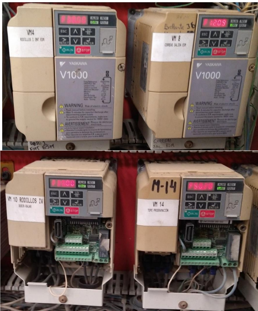
Figura 63-4.2-4 Etiquetado de variadores de apilado planta 1.
