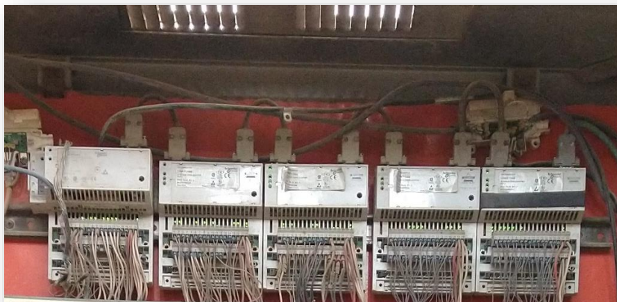
Figura 25-3.3-1. Contactores, pulsadores, relevadores, guardamotor, variadores de frecuencia..
