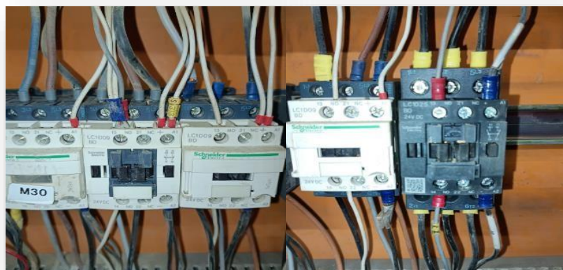
Figura 29-3.3-5. Contactos sin etiqueta y cables de señal sin etiqueta.
