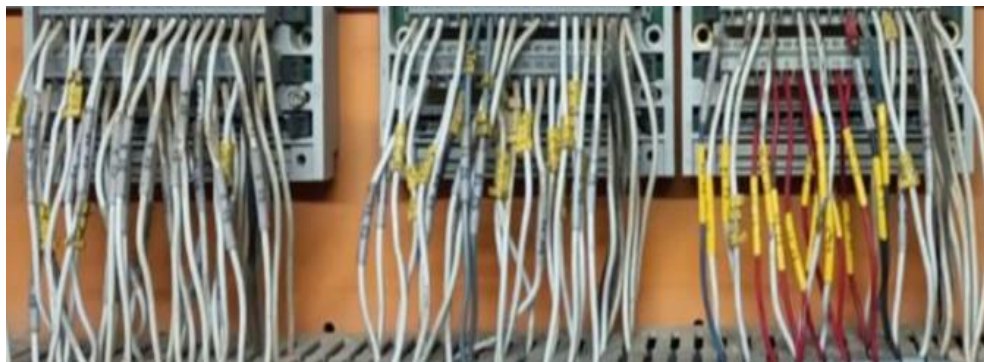
Figura 58-4.1.8-4 Etiquetado de los cables de las tarjetas de PLC.
