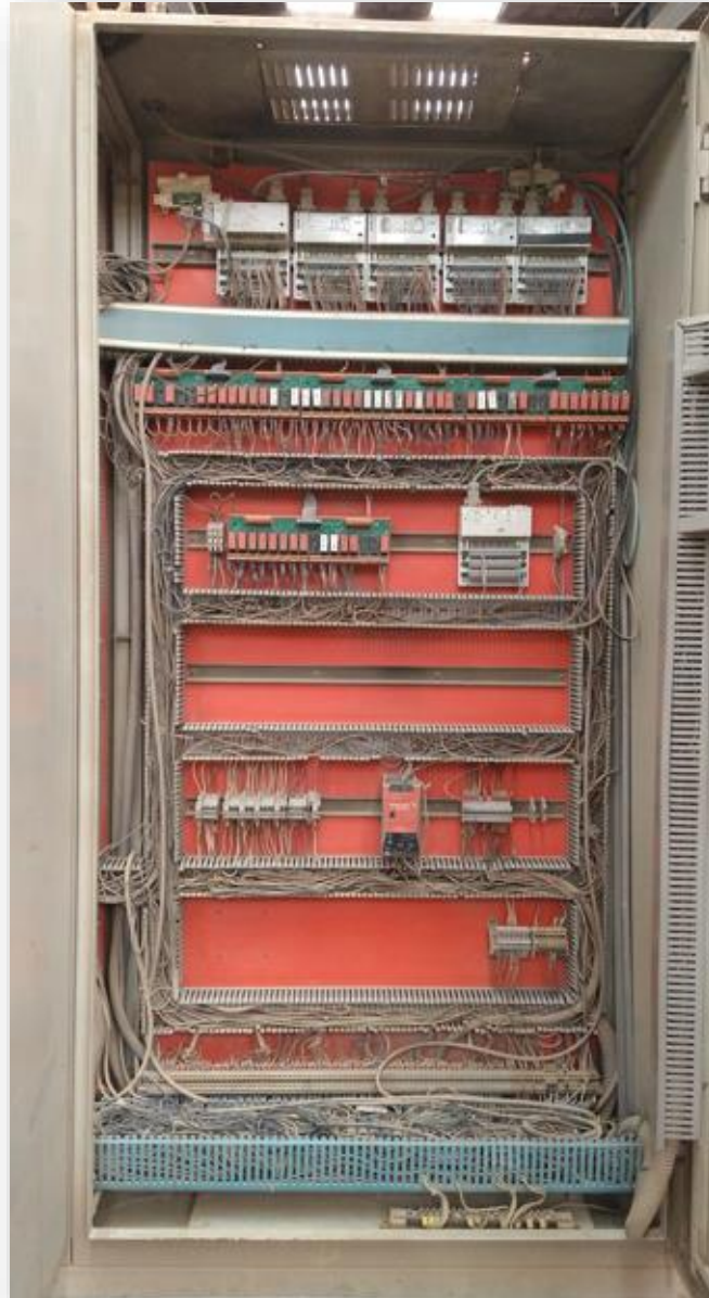
Figura 55-4.1.8-1 Peinado de cable del tablero de las tarjetas de expansión de PLC.
