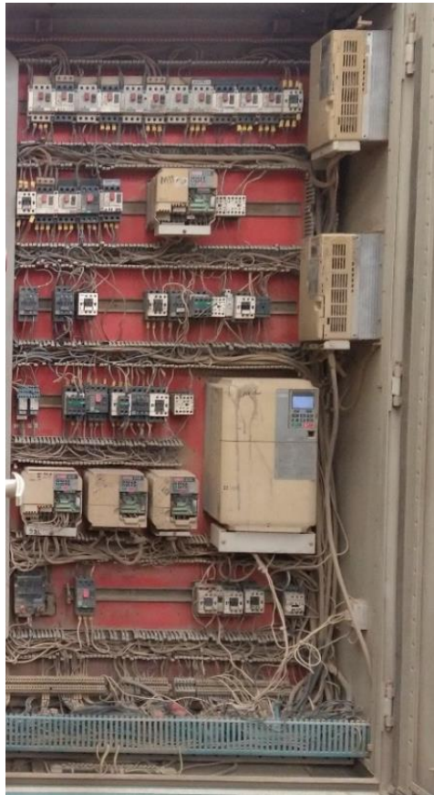
Figura 57-4.1.8-3 Peinado y acomodo de cables de tablero derecho de fuerza y control de apilado 1.
