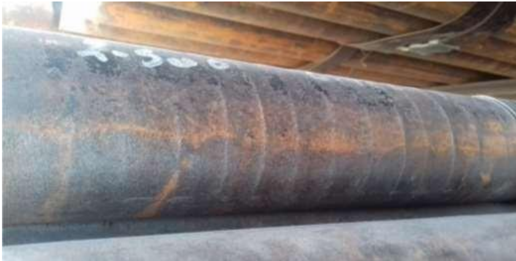
Ilustración 23: defecto superficial (marca). (simec(2024)).
