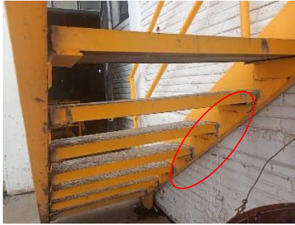
Corrosion de estructura, posible colapso.
