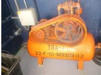
COMPRESOR DE RAMPA
