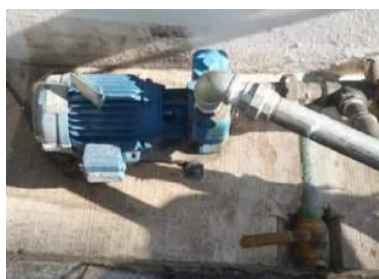
BOMBA DE AGUA (2)
