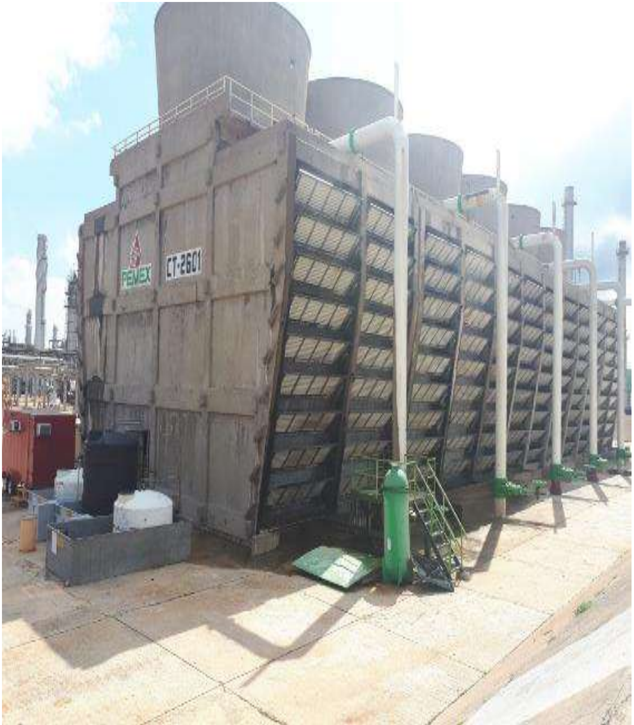
Figura 2.3 Torre de enfriamiento CT-2601 del CPG Nuevo Pemex.
