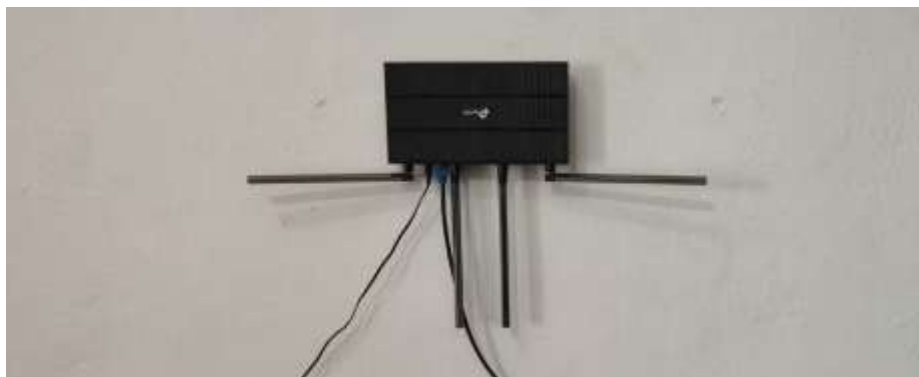
Figuras 23, 24 y 25: Instalación física de routers TP-LINK AC1500 en áreas estratégicas.
