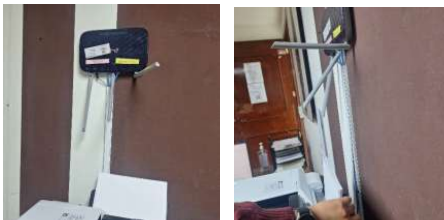
Figura 31: Instalación de router TP-Link Archer C20 para la conexión con el checador.
