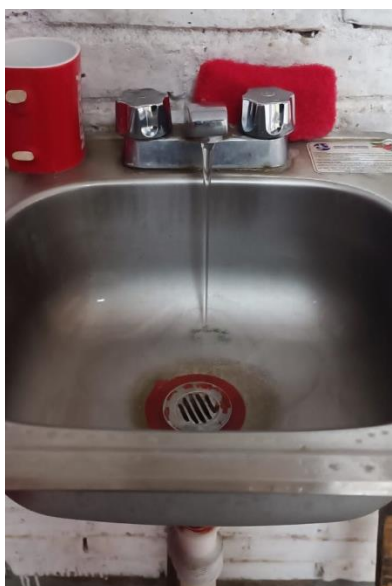
Ilustración 57 Lavabo del taller de electricidad.
