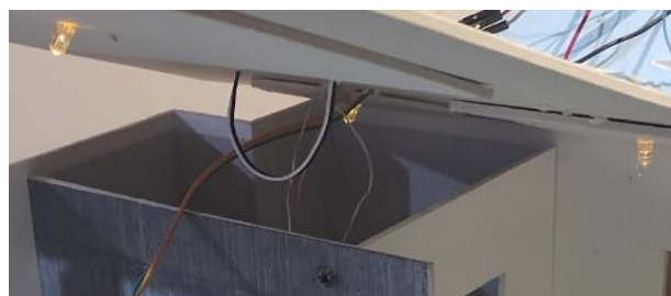
Figura 81 sistema de iluminación (Elaboración propia)
