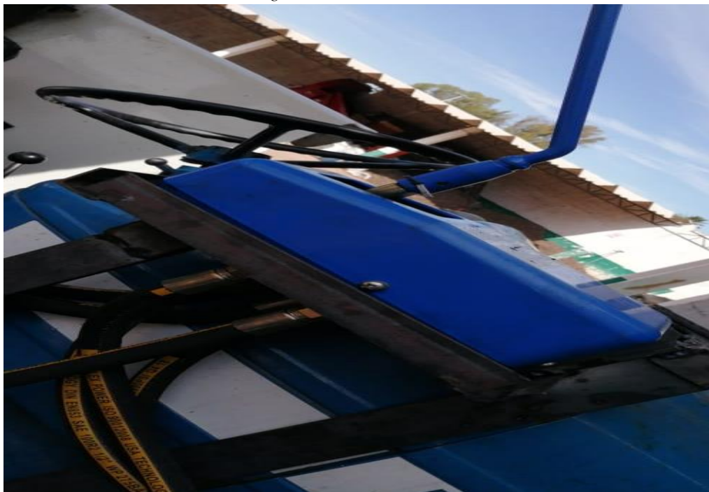
Figura 62. Caja de Válvulas.
