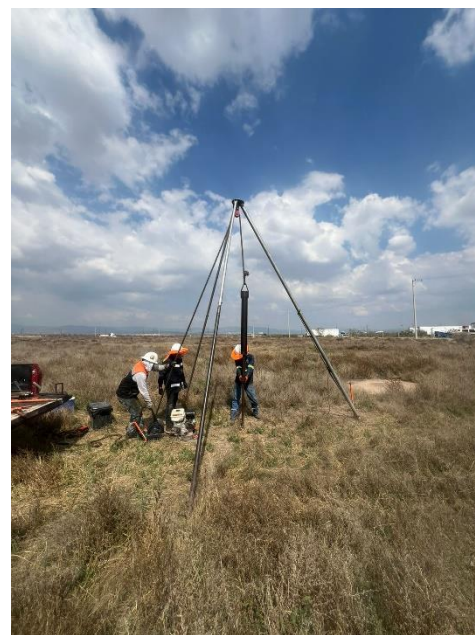
Ilustración 3 SPT 1 Zona de Tanques
