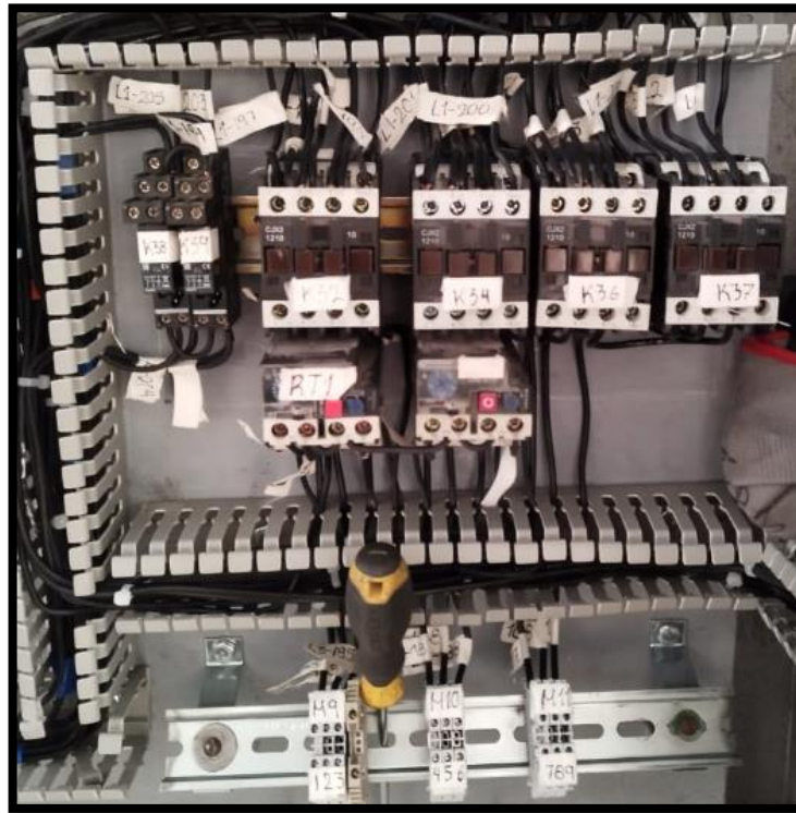
Imagen 95 Cableado y etiquetado del circuito de potencia
