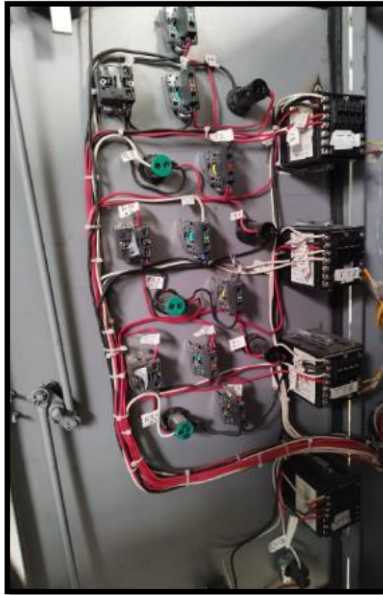
Imagen 74 Culminación de conexión de puerta izquierda del tablero
