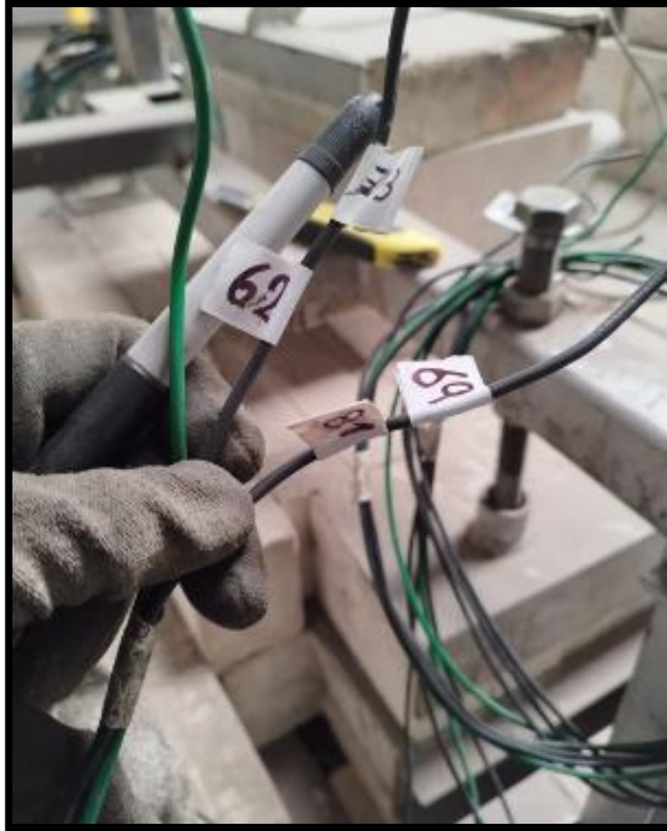
Imagen 109 Etiquetado de cables
