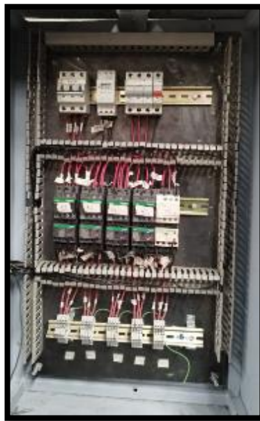
Imagen 118 cableado de componentes
