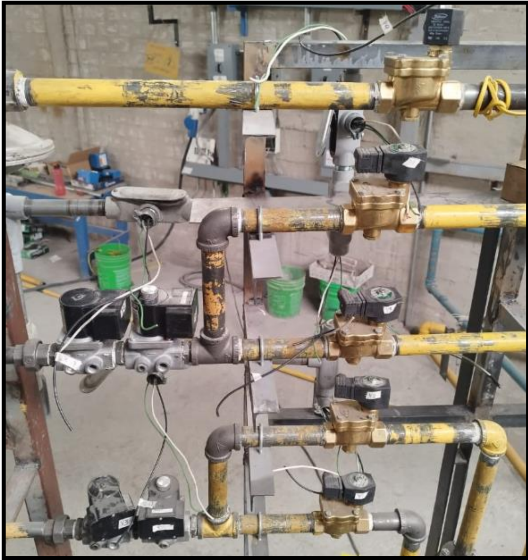
Imagen 112 conexión de electroválvulas
