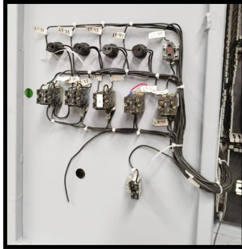
Imagen 119 cableado de indicadores de control
