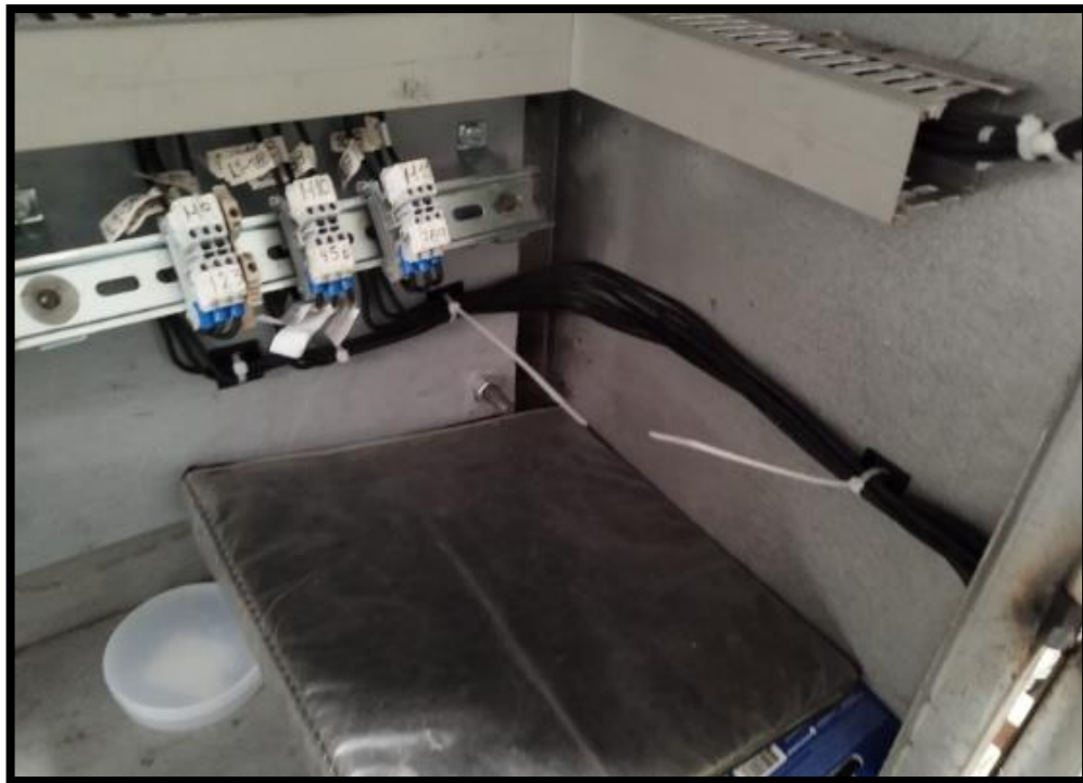
Imagen 111 conexión de borneras de motores en campo
