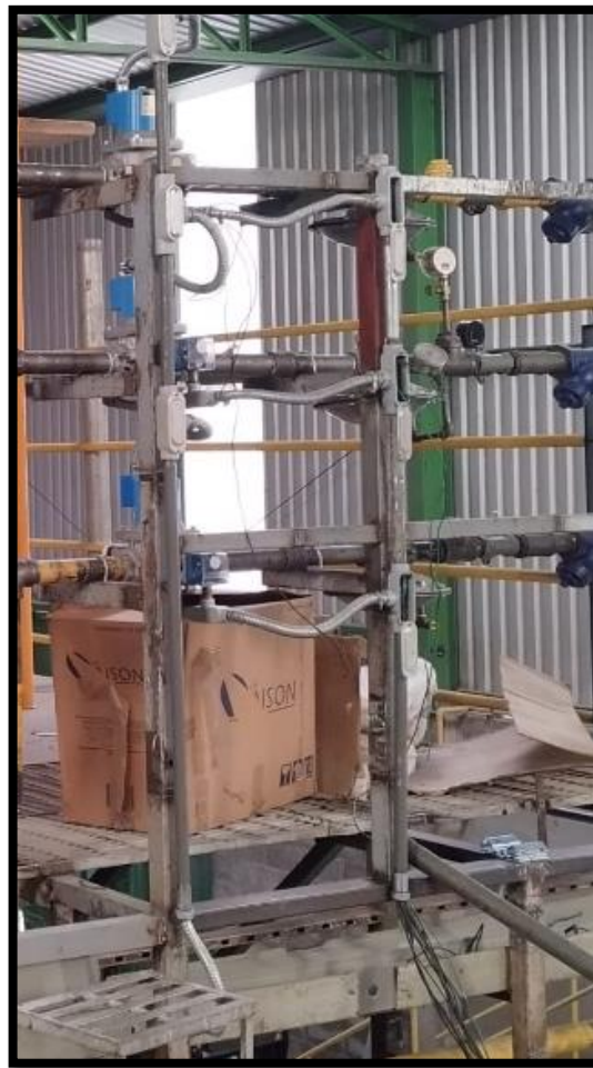
Imagen 80 conexión de electroválvulas de horno de fundición
