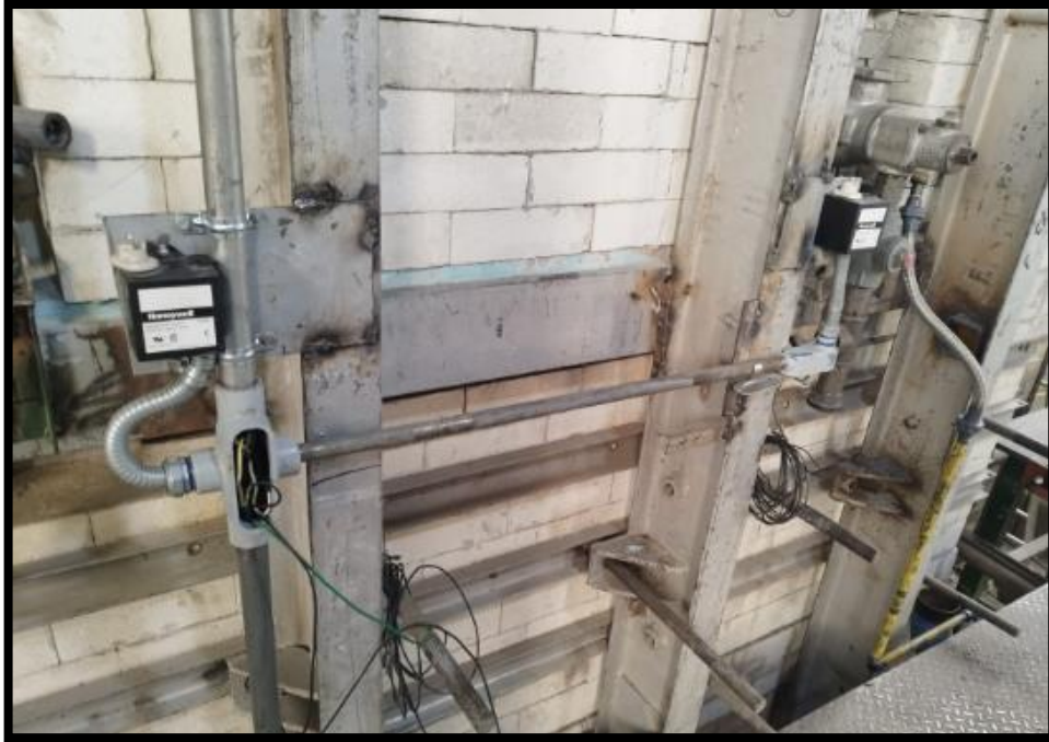
Imagen 81 conexión de transformadores de ignición
