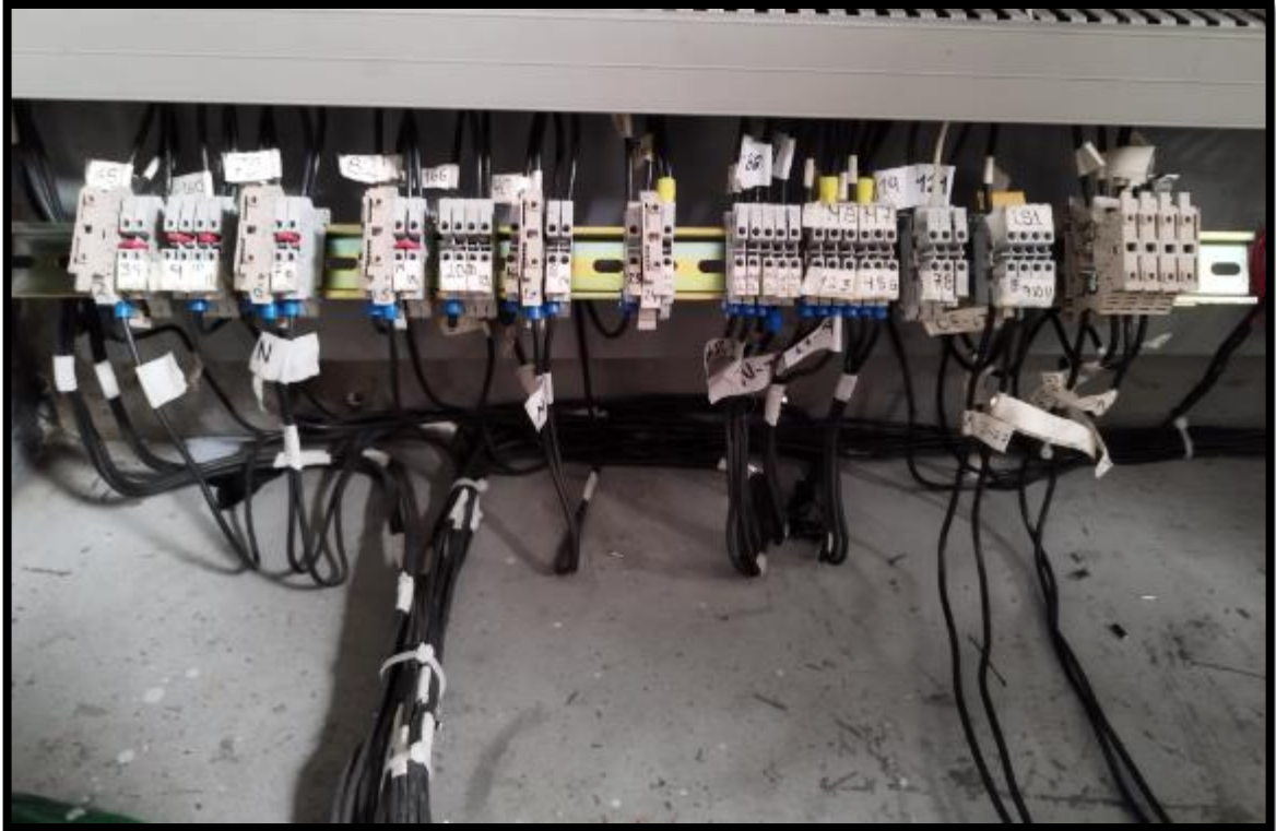
Imagen 110 conexión de borneras de componentes de campo
