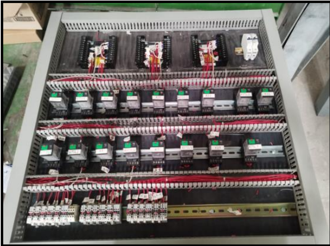
Imagen 68 Cableado de componentes de la placa de montaje
