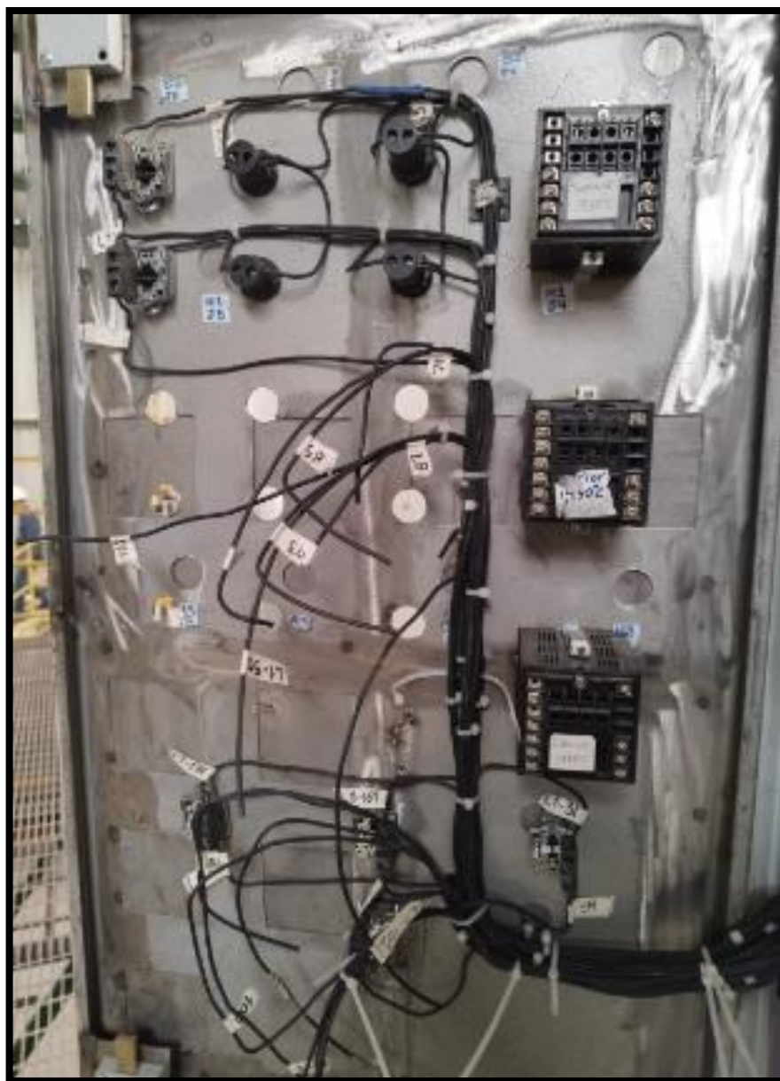
Imagen 100 Conexión y peinado de cables de puerta izquierda del tablero
