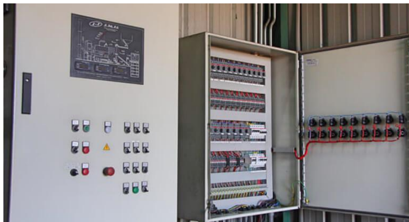
Figura 7. Subestación perfectamente instalada con su conexión eléctrica con su correcto enrutamiento.
