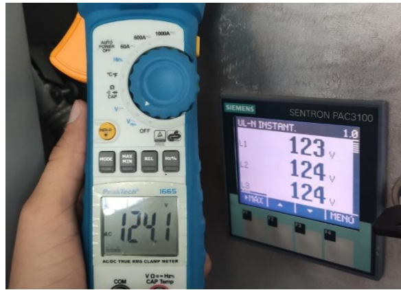
Figura 68. Tensión medida en línea 1.
