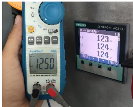
Figura 70. Tensión medida en línea 3.
