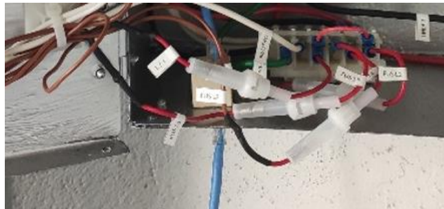
Figura 77. Continuidad de señal por cople.
