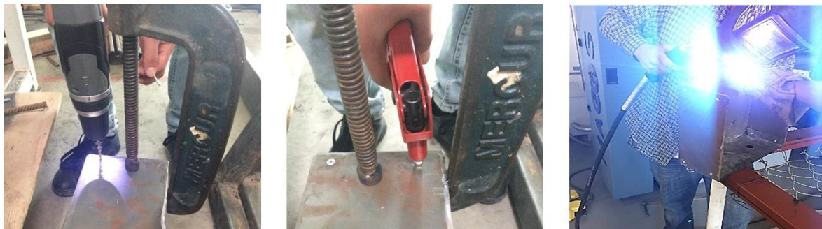
Figura 58. Procesos de perforación (izq.), remachado (centro) y soldadura (der.) de gabinete de control.
