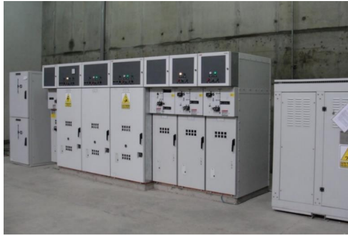
Figura 6. Subestación eléctrica tipo compacta dentro de una industria.
