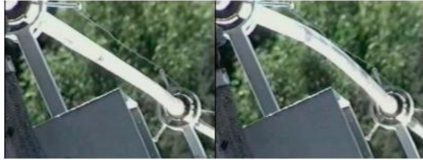
Figura 1.8. Deformación del tubo absorbedor [27]
