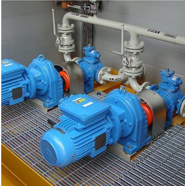
Fig. 2.11.2 En estas imágenes se muestran diversas aplicaciones de los variadores de velocidad en bombas, bandas, sopladores, etc.
