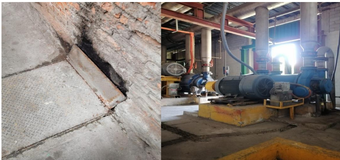
Ilustración 13 pruebas en bombas de vacío de agua tratada de Hovomex SA.de.CV
