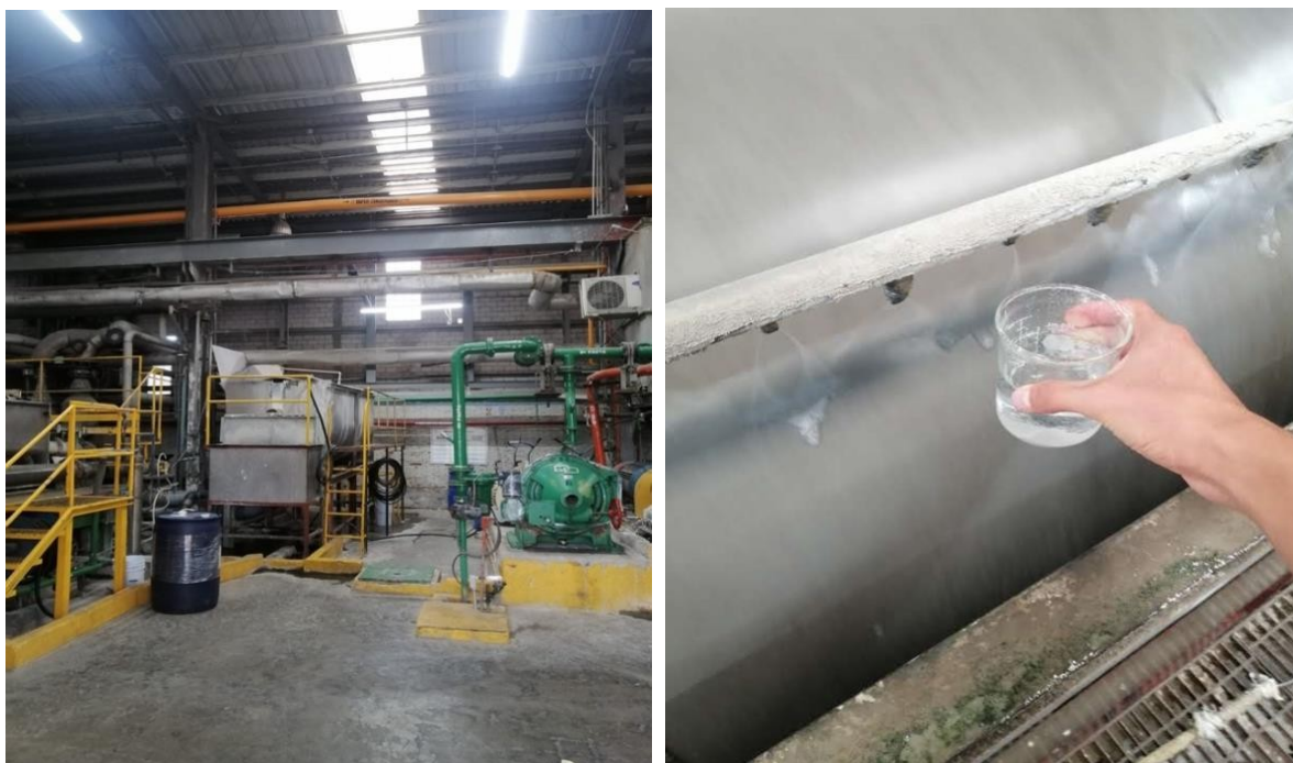
Ilustración 14 pruebas en Recuperador de agua tratada de Hovomex SA.de.CV.
