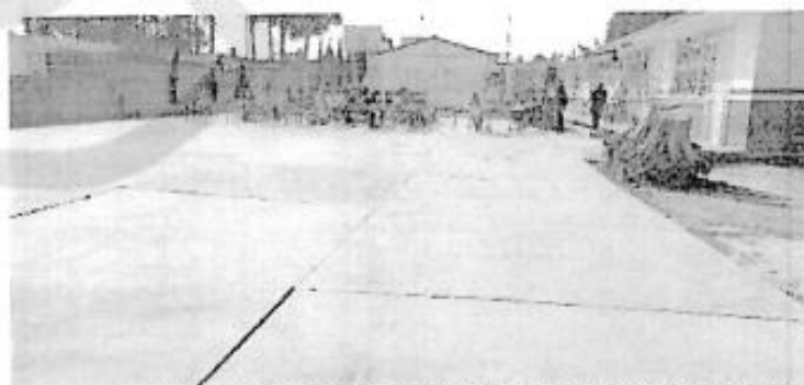
SE OBSERVA HUNDIMIENTO DE PISO DE CONCRETO EN LA CANCHA DE BASQUETBOL
