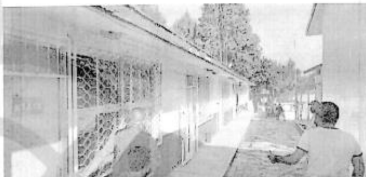
SE OBSERVA DETERIORO DE PINTURA Y PUERTAS DEL EDIFICIO "B"
