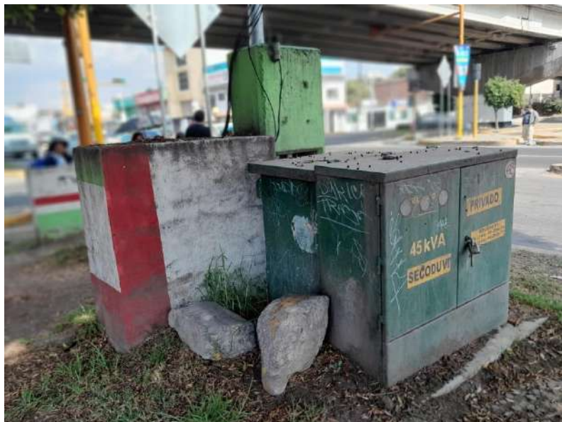
Figura 4.27 Localización de registro de centro de carga. Fuente propia.
