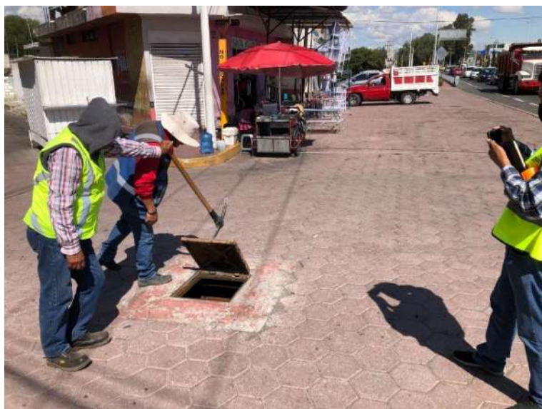
Figura 4.28 Localización de registro de agua potable. Fuente propia.
