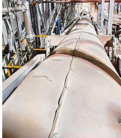
Maquinaria Imagen 9 Tubos de enfriamiento
