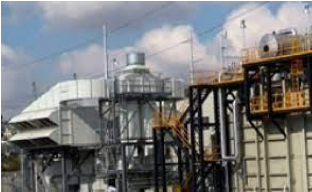
Turbina de Gas, Generadora de Energía Eléctrica
