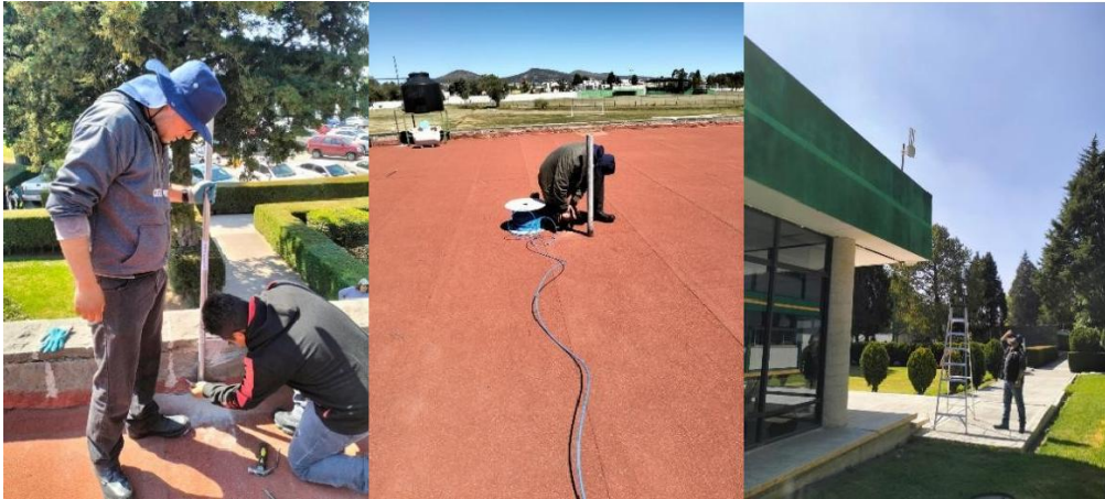
Figura 16 Instalación física de puntos de acceso H3C en edificios del ITA
