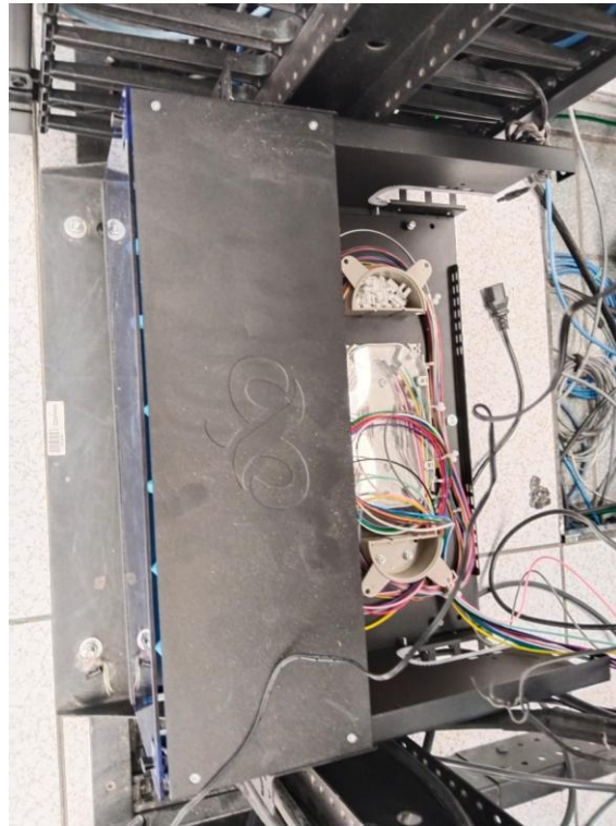
Figura 9 Diagnóstico del rack del servidor durante la modernización de la red.
