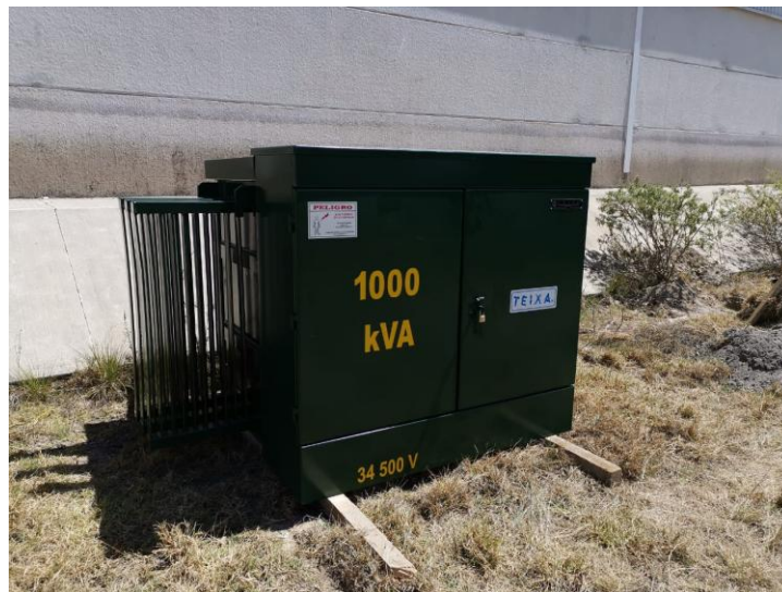
Imagen 3.58 Transformador principal capacidad 1000 kVA
