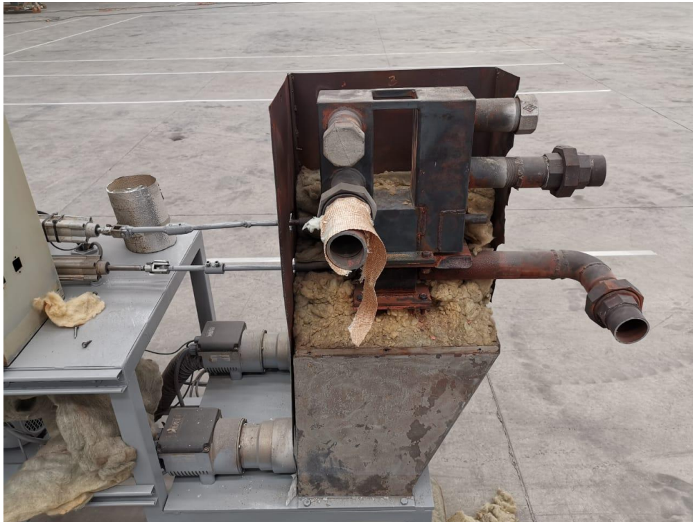
Imagen 3.79 Elementos para restructuración y conexión de los hornos eléctricos
