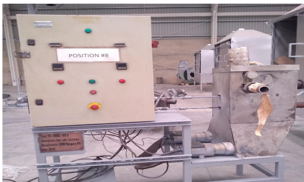
Imagen 3.10 Tablero de control para hornos eléctricos
