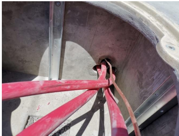
Imagen 3.73 Conexión de alta tensión para transformador
