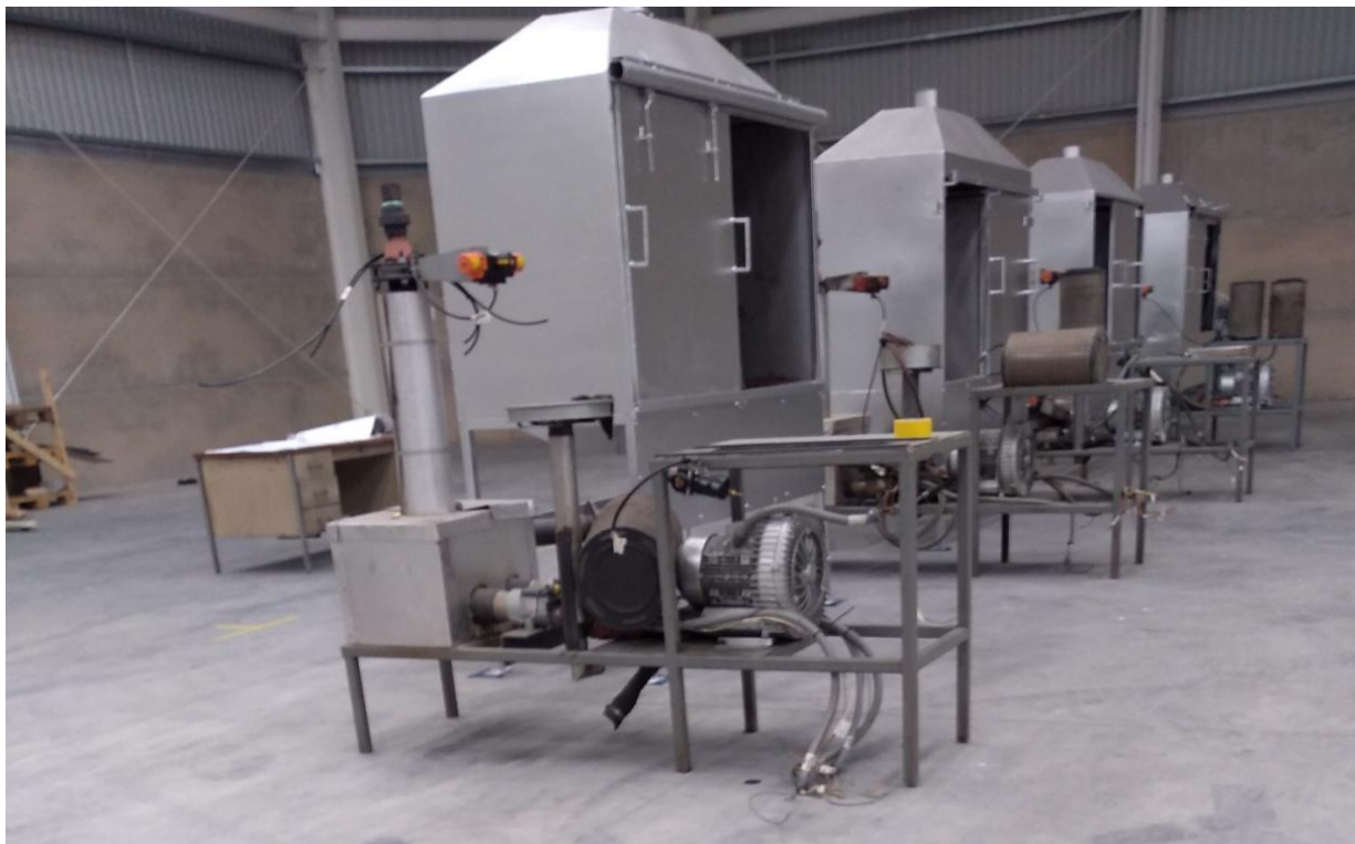
Imagen 3.6 Estructura de hornos eléctricos con bases.
