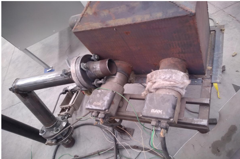
Imagen 3.82 Tuberías sueltas sin instalar
