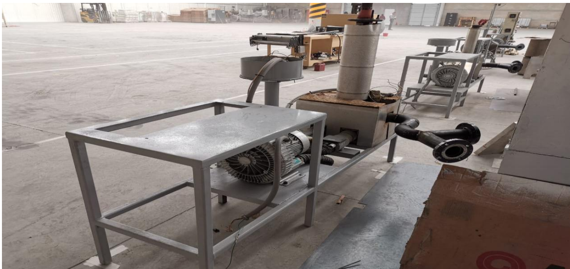
Imagen 4.6 Conexiones en proceso hornos eléctricos
