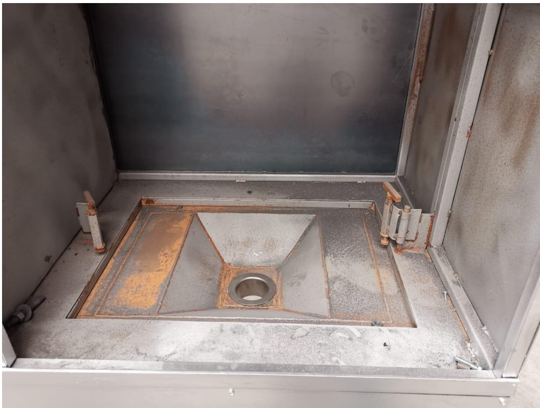
Imagen 3.80 Cámara principal de hornos eléctricos
