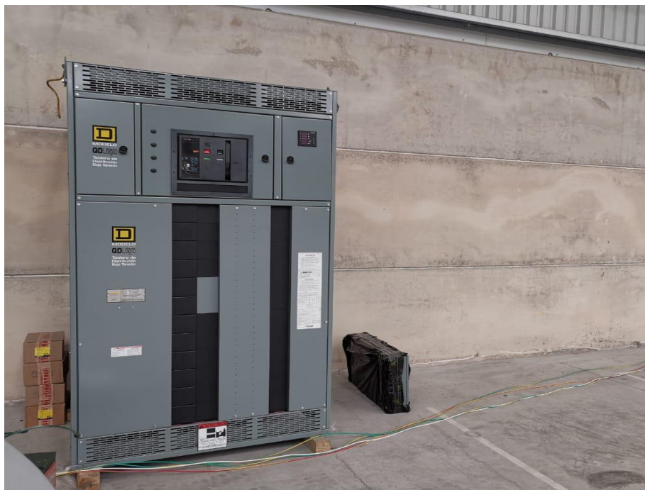
Imagen 3.54 Tablero QD logic,
