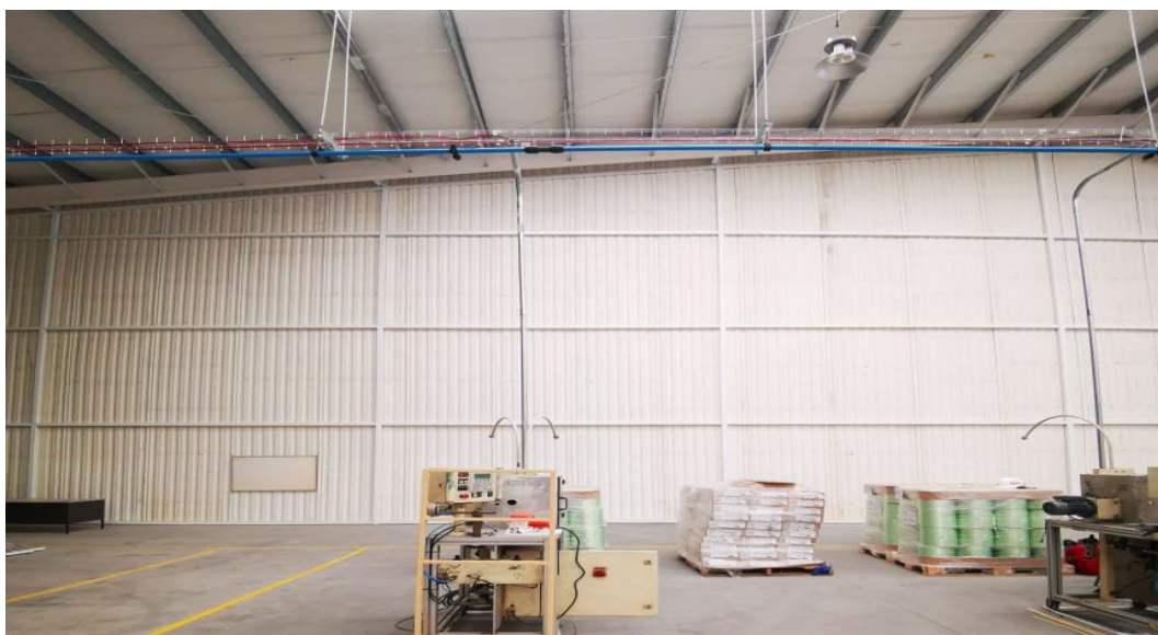
Imagen 4.5 Conexión final de empacadoras
