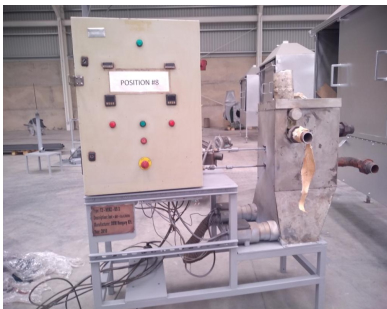
Imagen 3.91 Tablero de control de horno eléctrico
