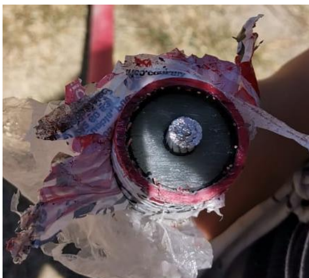
Imagen 3.72 Longitud de cable para conexión de transformador
