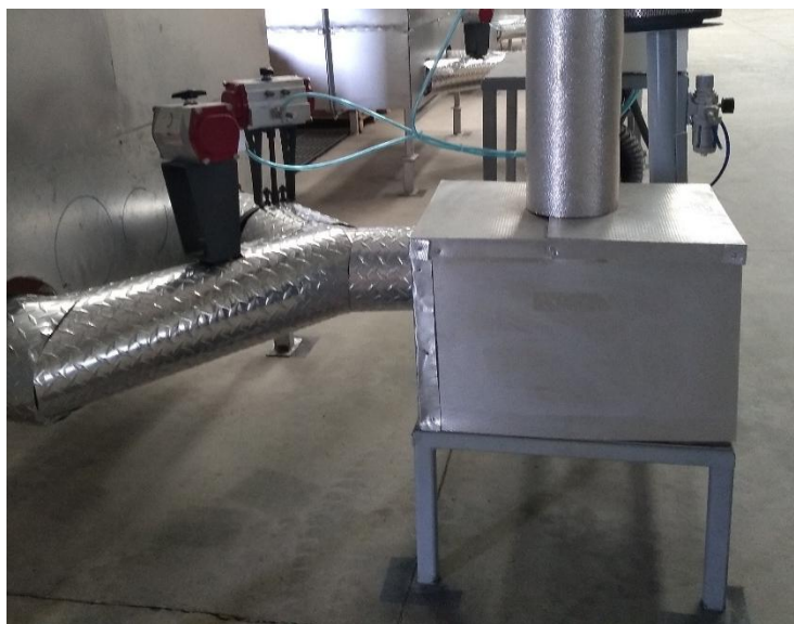
Imagen 3.85 Conexión de tuberías y protecciones térmicas para hornos eléctricos
