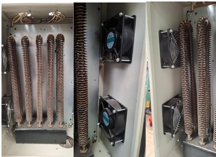
Ilustración 56. Montaje y visualización de resistencias y ventiladores
