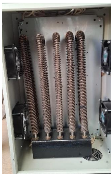
Ilustración 61. Vista del montaje y conexión de las resistencias al interior del banco
