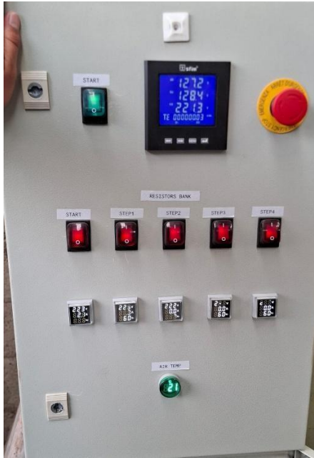
Ilustración 63. Banco encendido prueba de funcionamiento de etapas escalonadas
