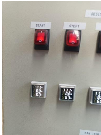
Ilustración 75. Al ser sometida a la 3ra carga el banco otorga 9 amperes.
