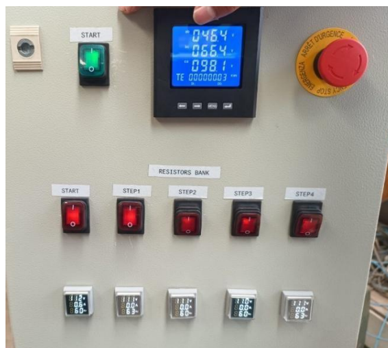
Ilustración 74. Prueba al vacío otorgo una corriente de 0 amperes, por cada etapa iba aumentando gradualmente.
