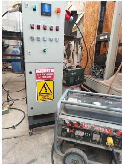
Ilustración 71.: Conexión del banco resistivo con generador de electricidad.
