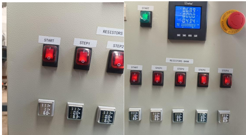
Ilustración 76. En la última carga se registró un amperaje de 11 amperes y un voltaje sumado de 112.3 V
