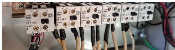
Ilustración 55. Conexión de los contactores eléctricos con las resistencias y ventiladores.
