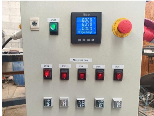
Ilustración 73. Frecuencia otorgada del generador al banco resistivo
