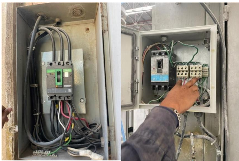
Ilustración 20 Tableros de conexión eléctricos
