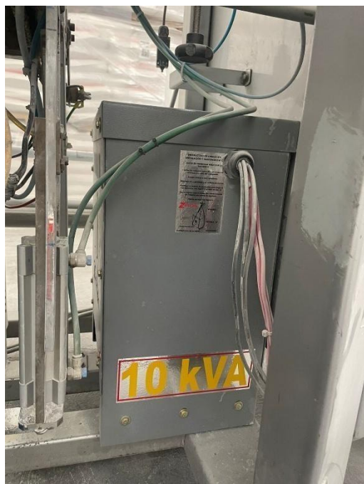
Ilustración 21 Transformador utilizado en enfardadora
