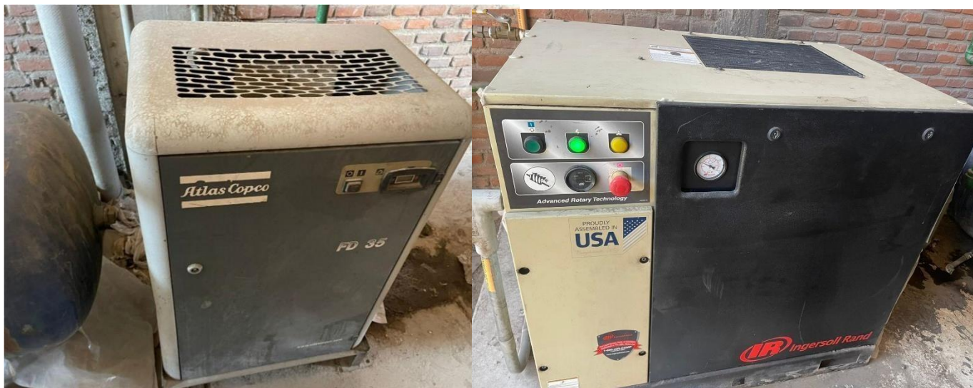
Ilustración 22 compresor utilizado para la conexión neumática
