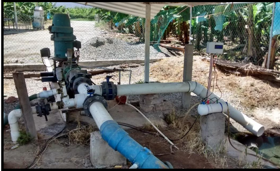
Figura 3.7 Instalación del módulo de medición.
