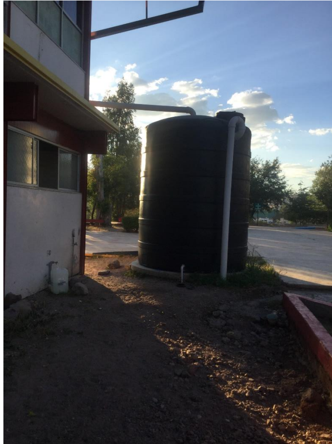
Figura 57: Cisterna de aguas colectadas de lluvias.
