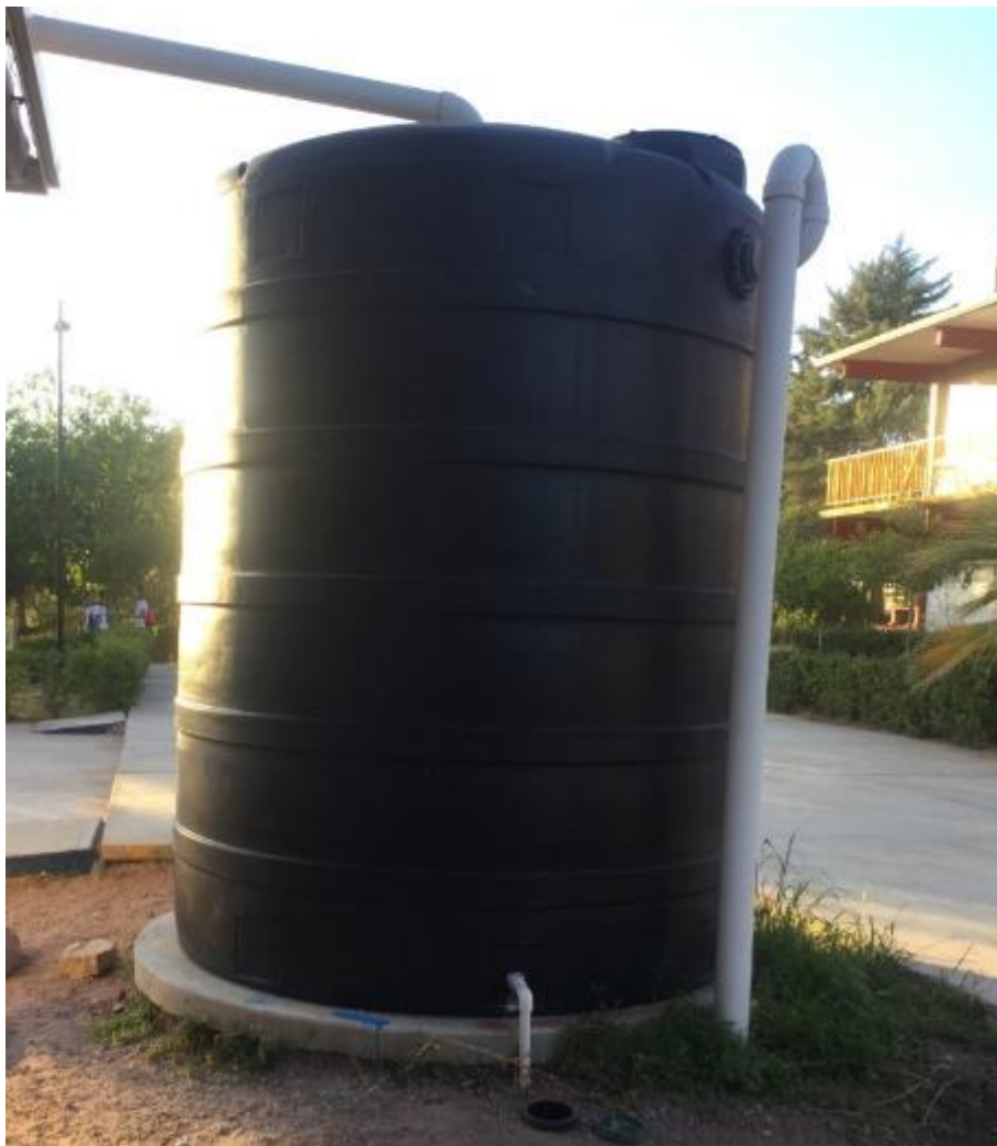
Figura 14: Cisterna de aguas colectada de lluvias.
