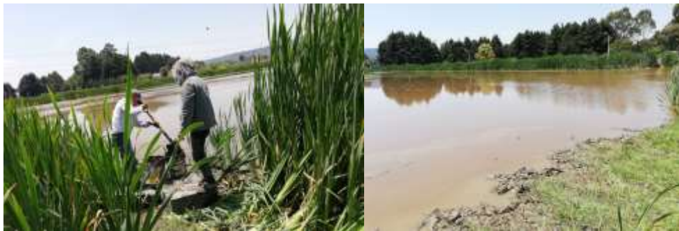
Figura 2.21 Obtención del lodo de manera manual en la planta potabilizadora (presa de lodos).
