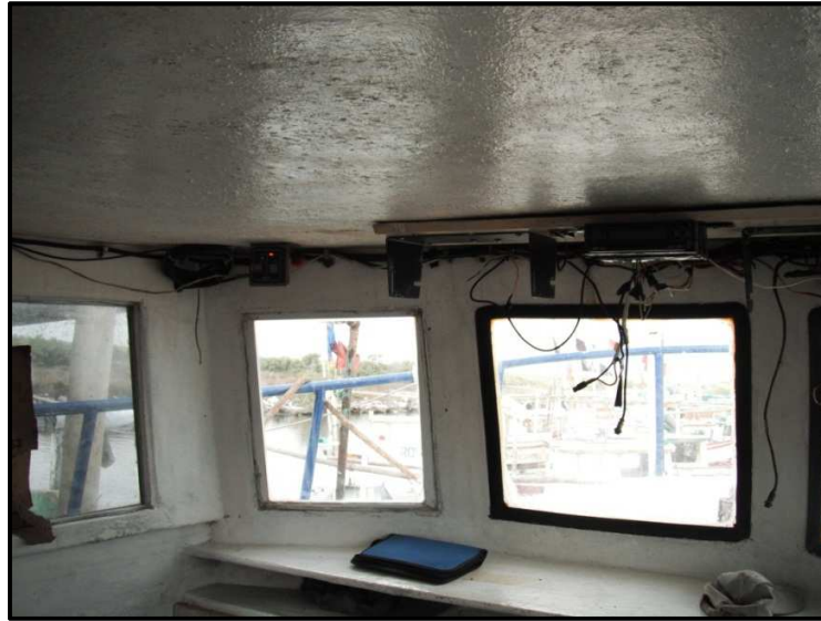
Figura 3.5 Dispositivo SISMEP instalado en una embarcación de flota mediana (2)
