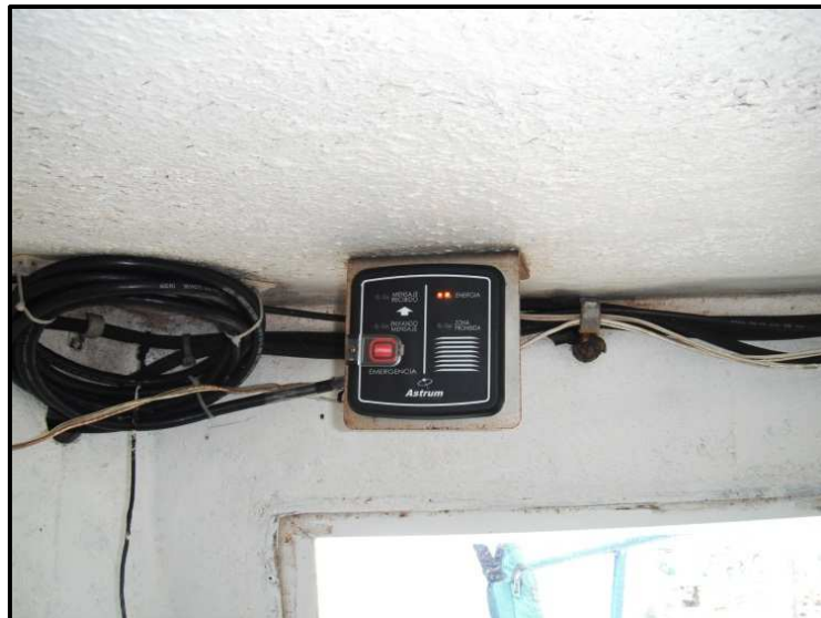
Figura 3.4 Dispositivo SISMEP instalado en una embarcación de flota mediana (1)
