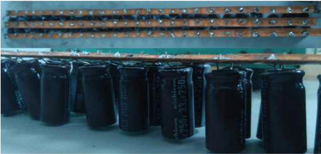
Figura 4.6: Vista superior y vista lateral del banco de capacitores electrolíticos de aluminio, conectados como se sugiere en [120].
