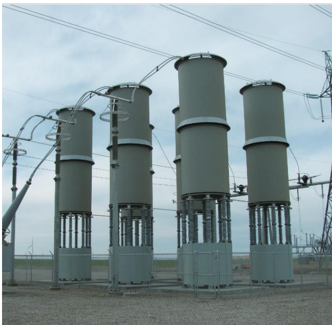
Figura 2.1.- Reactores eléctricos de potencia.
