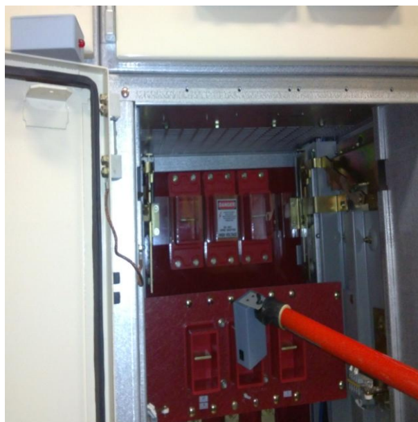
Figura 6.5. Prueba del dispositivo detector en el lado de contactos hacia el equipo 241-P-0100AM, el cual estaba fuera de servicio y se verificó correctamente la ausencia de tensión de la fase B en 4.16kV.
