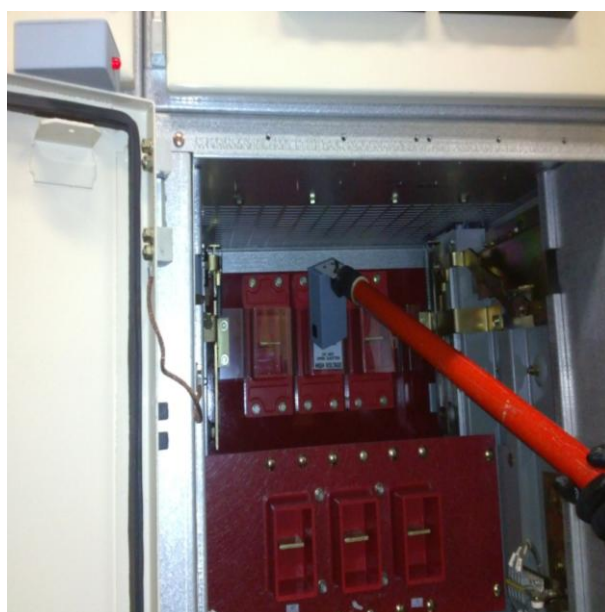
Figura 6.6. Prueba del dispositivo detector en el lado bus del tablero, el cual estaba energizado y se verificó correctamente la presencia de tensión en la fase B en 4.16kV.
