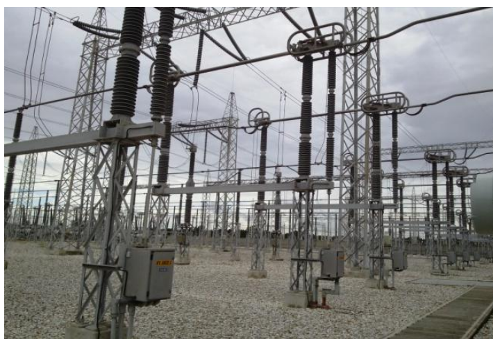
Figura 6.1. Bahía 400 kV SE Altamira III y IV.
