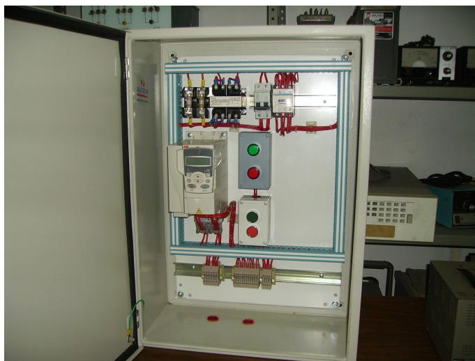
Figura 3.10: Gabinete del variador de velocidad.
