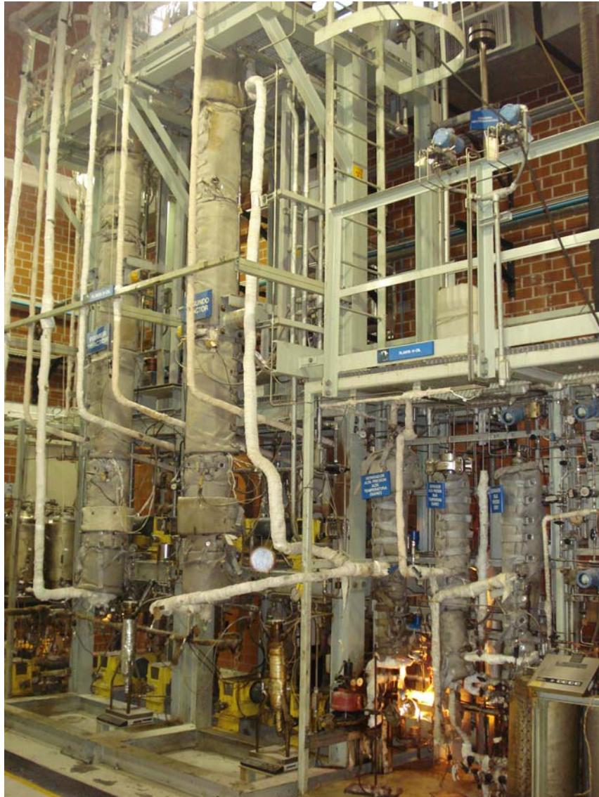
Figura 2.7. Planta piloto de hidrodesintegración de fracciones pesadas del petróleo a condiciones de presión y temperatura elevadas
