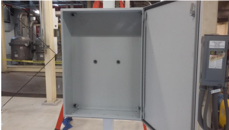
Figura 25. Tablero principal montado en estructura.
