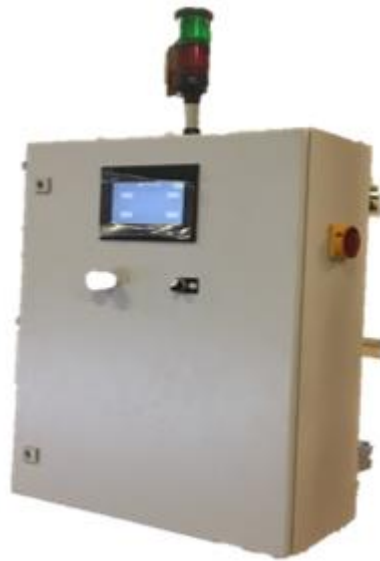
Figura 43. Vista frontal tablero principal.
