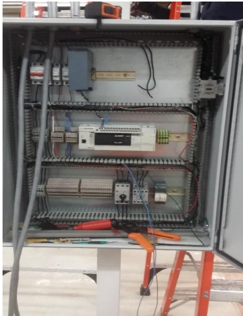
Figura 33. Integración de clemas en tablero principal.
