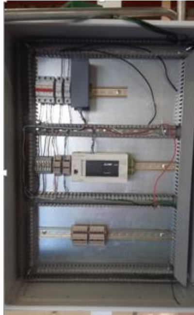
Figura 32. Platina montada en tablero principal.
