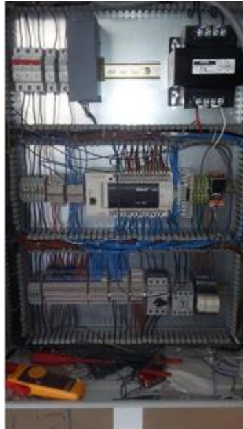
Figura 35. Cableado de salidas del PLC.
