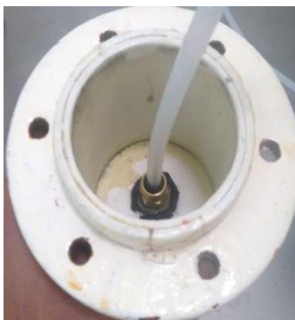
Figura B.2 Tubo de aireación en inyector 1
