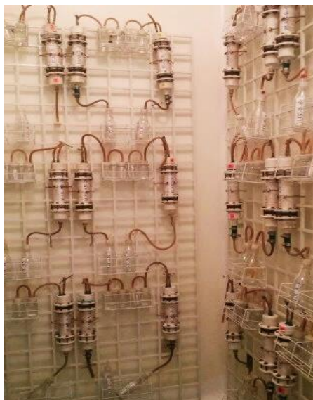
Figura 3.10 BLAB para inicio de operación
